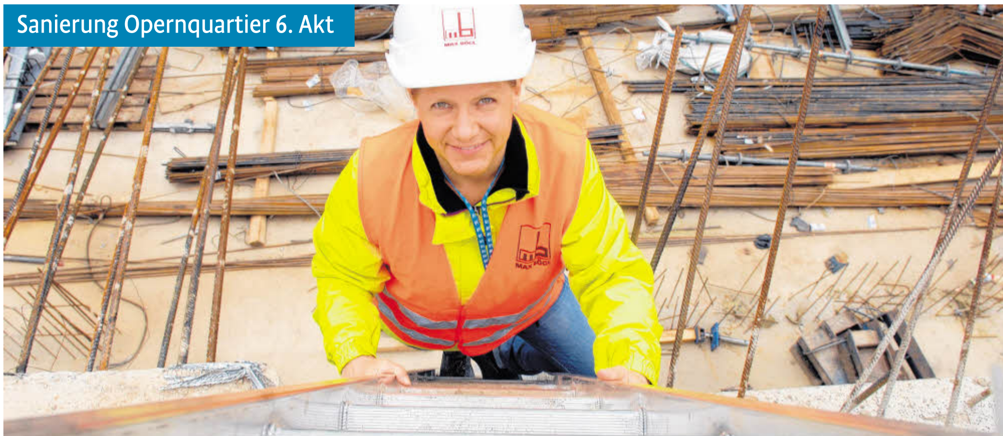
Inka Helle ist zuständig für die Bewehrungsbestellung und die Sanierung der Bestandsschächte. Die gebürtige Finnin ist die einzige weibliche Bauleiterin am Opernquartier.
